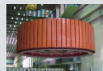
水車発電機回転子 Rotor of hydro generator
