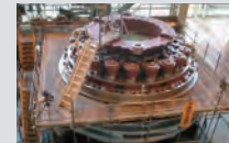
ポンプ水車静止部および開閉機構 Stationary parts and operating mechanism for pump-turbine
