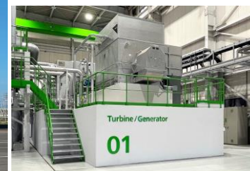
タービン発電機
