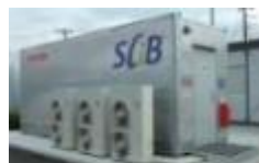
横浜スマートシティ プロジェクト 300kW-100kWh
