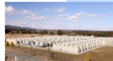
東北電力ネットワーク(株) 南相馬変電所 40MW-40MWh
