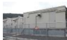
九州電力送配電(株) 竜郷変電所 2MW-774kWh
