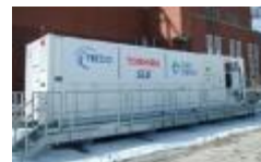
Duke Energy (USA) 2MW-0.8MWh
