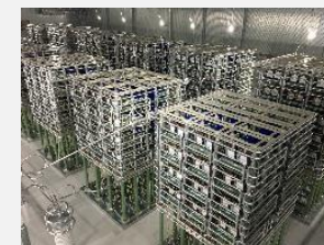
日本初の自動式 高電圧直流送電システム (HVDC)
