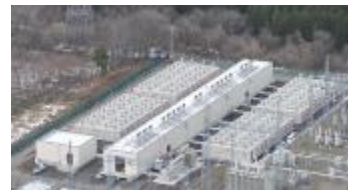
東北電力ネットワーク(株) 西仙台変電所 40MW-20MWh
