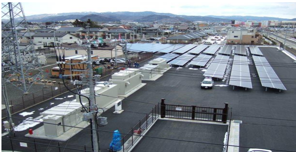
石巻蛇田太陽光発電所
