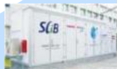
関西電力(株) 技術研究所 100kW-300kWh
