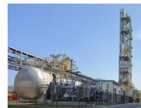
佐賀市清掃工場 CCU*2プラント
