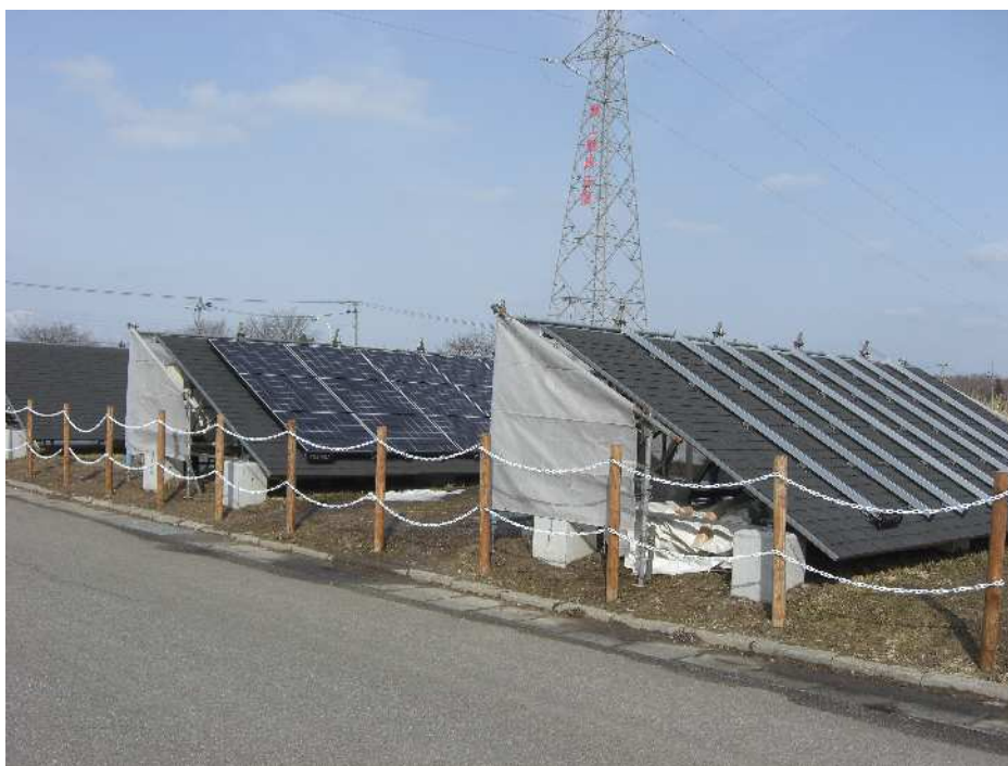
《太陽光パネル》
