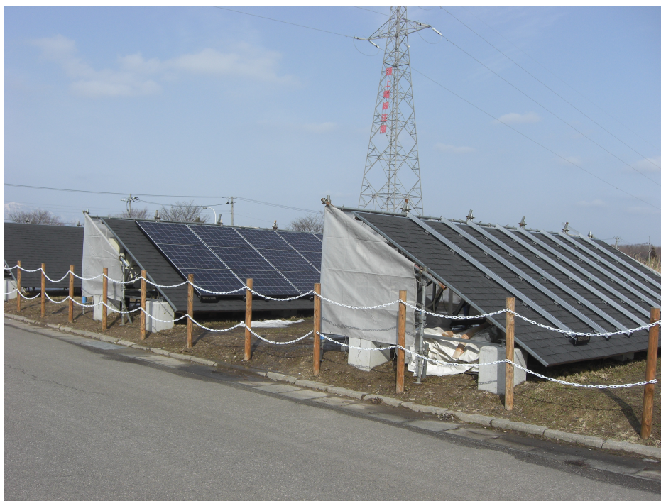
《太陽光パネル》
