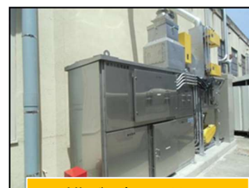
排ガス処理装置
