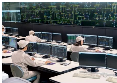
● 電力系統監視制御システム
