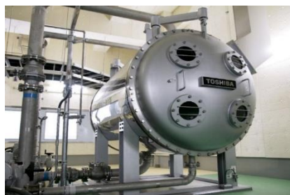
● オゾン発生装置
