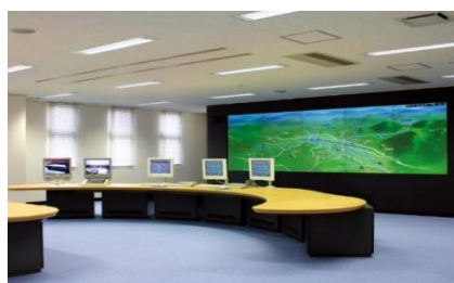
● 上下水道監視制御システム
