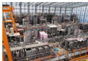
多核種除去設備
