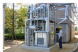
二酸化炭素回収試験設備
