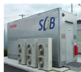
需給調整用蓄電池
