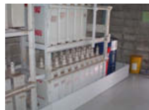
日本環境安全事業（株）へのPCB機器搬出
