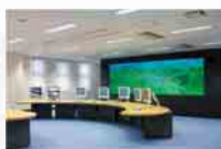
監視制御システム
