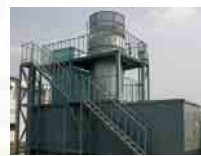
曝気レス水処理フィールド試験装置 (日本下水道事業団技術開発実験センター内)
