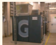
コンプレッサーシステム 年間100MWh 削減
