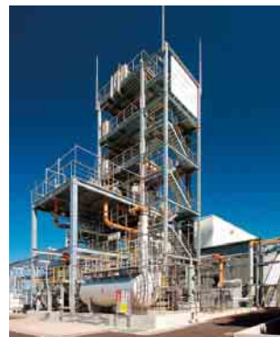
CCSパイロットプラント（福岡県大牟田市、 （株）シグマパワー有明三川発電所内）
