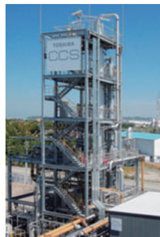
CCSパイロットプラント（福岡県大牟田市、(株)シグマパワー有明三川発電所内）
