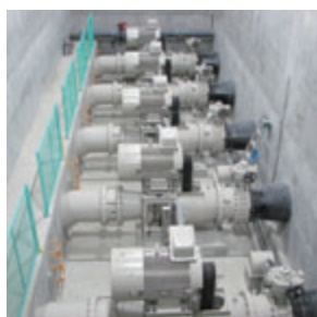
三峰川電力(株)様三峰川第四発電所
