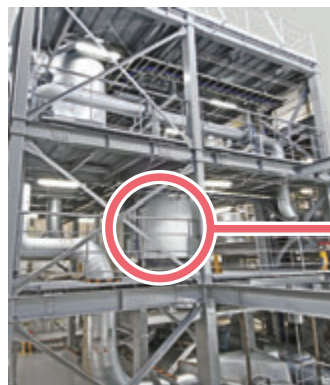
高速炉研究開発設備(ナトリウムループ設備)
