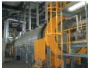
熱分解ガス化装置
