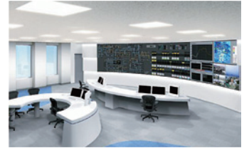
電力系統監視制御システム Supervisory Control And Data Acquisition Systems (SCADA)
