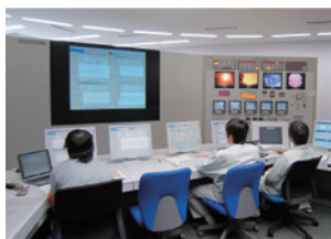
中央制御室 (関西電力株式会社様) Central Control Room (Kansai Electric Power Co., Inc.)
