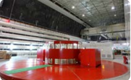
葛野川発電所 (東京電力リニューアブルパワー株式会社様)
