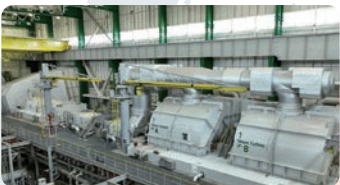
五井火力発電所 (五井ユナイテッドジェネレーション合同会社様)
